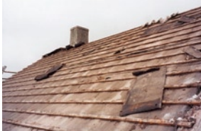
Schädigung der Bausubstanz: z.B. Schimmel
